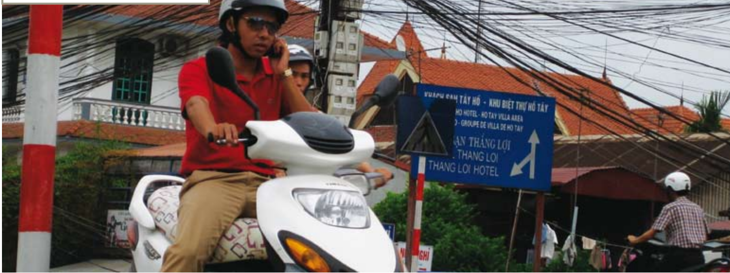
Elförsörjningen i Hanoi skulle nog ge SEMKO-personalen en kollektiv hjärnblödning. El- och teleledningar i ett virrvarr, men trots detta drabbades inte vi av några avbrott.
